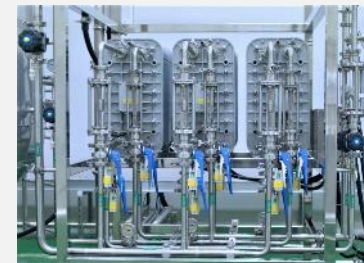
純水製造装置
