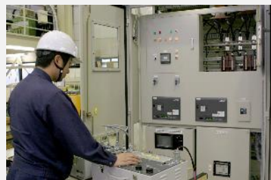
データセンター向け制御盤
