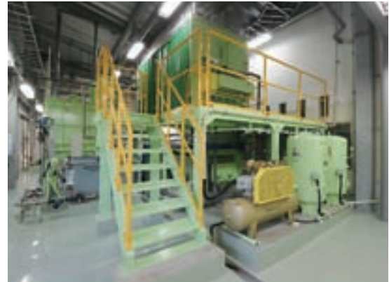
三宅村汚泥再生処理センター「汚泥脱水設備」 (山田工業(株))
