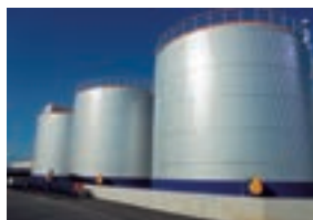
食用油脂貯蔵タンク
