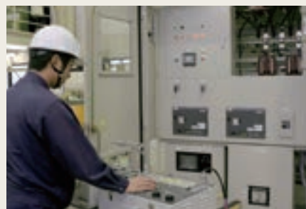
キュービクル(配電盤)
