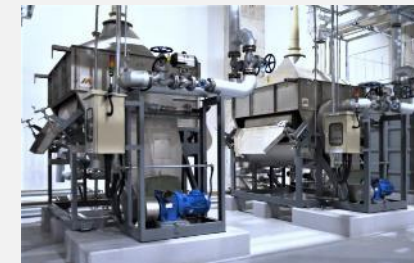
排水処理装置
